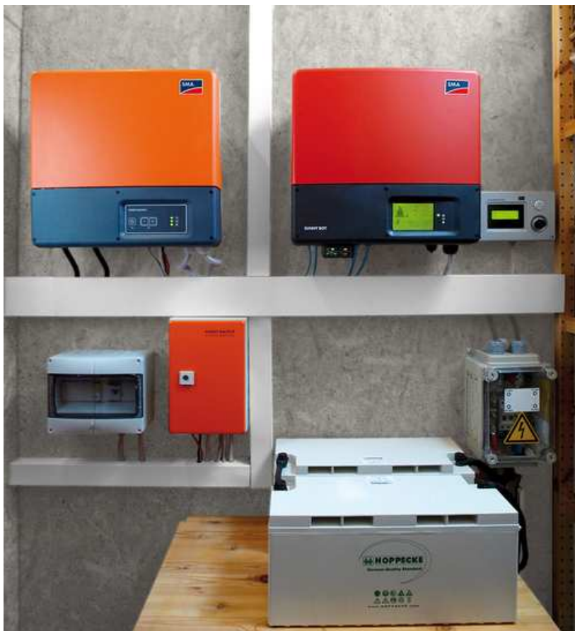
Abb.3: Hightech für maximalen Eigenverbrauch – das Sunny Backup-System von SMA
